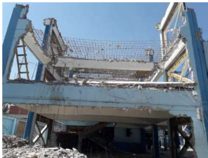
Aspecto de una demolición parcial de la secundaria México Tenochtitlan, en Iztapalapa, la cual tuvo daños en parte de uno de sus edificios, debido a una greita en la zona. Es una de las nueve escuelas catalogadas con daño severo o daño estructural. Foto tomada en marzo de 2018.
