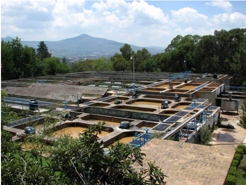
Planta potabilizadora de la tenencia de Santa María, la cual tiene 60 años operando desde su construcción, y continúa proporcionando agua 100% potable a la población de Morelia.
